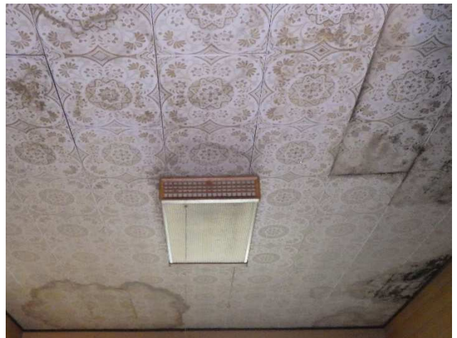
15点 （屋根ぶき材料の一部に剥落又はずれがあり、雨もりのあるもの）
