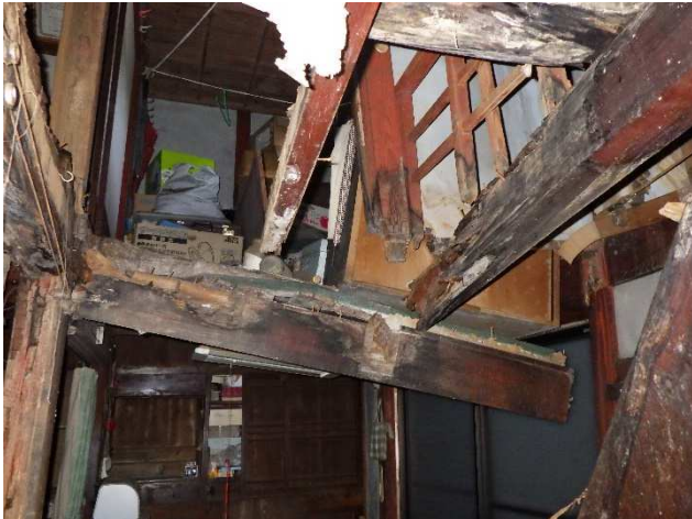
100点 （基礎、土台、柱又ははりの腐朽、破損又は変形が著しく崩壊の危険のあるもの）
