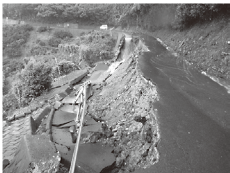
◀崩落した町道
