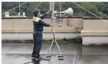
庁舎屋上にアンテナを設置し、FMラジオの臨時災害放送を実施。災害状況や避難経路の情報を発信しました。
