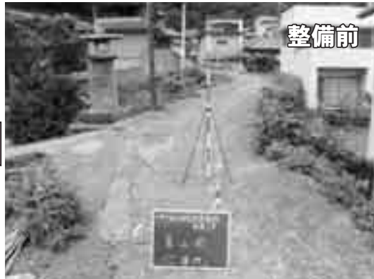
路面に陥没箇所等があり、歩行に支障をきたす恐れがありました。
