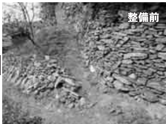
路面が舗装されておらず、歩行に支障をきたす恐れがありました。
