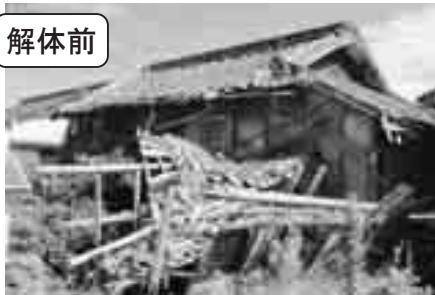
解体前は、住宅が崩れる危険性
