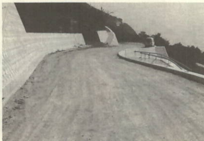
▲県営緊急畑地帯総合整備事業(大久) 農業生産性の向上及び輸送経費の節減の ため農道新設中で、今年度は舗装工事に着 手予定でです。
