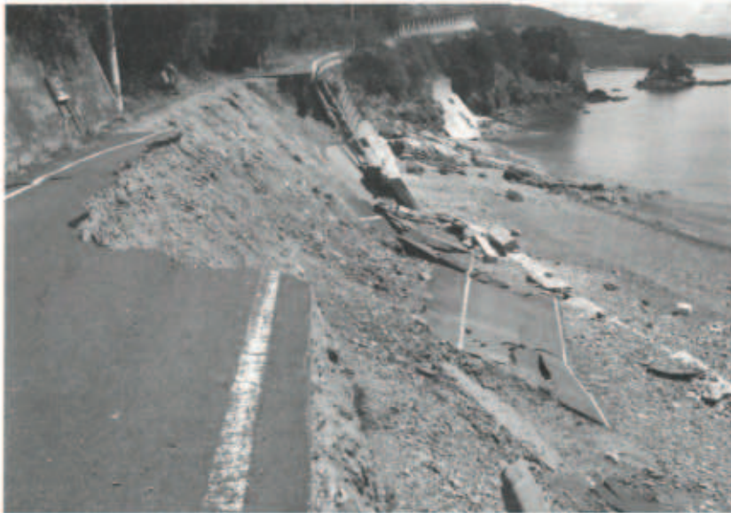
▲台風の高波に崩壊した町道（加周地区）
