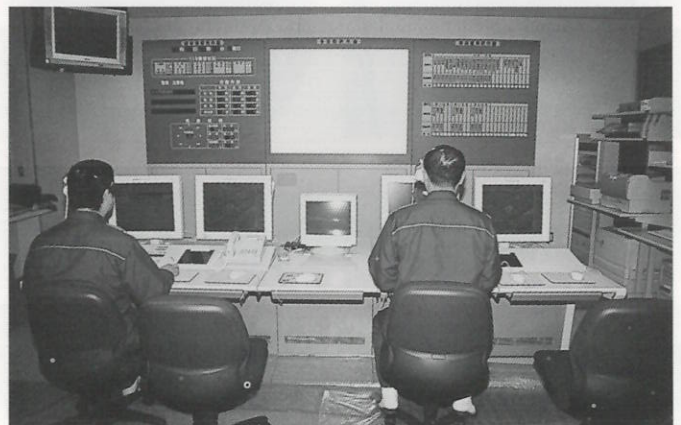
▲ 消防緊急通信指令システム
