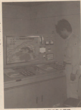
コンピュータ制御で集中管理
