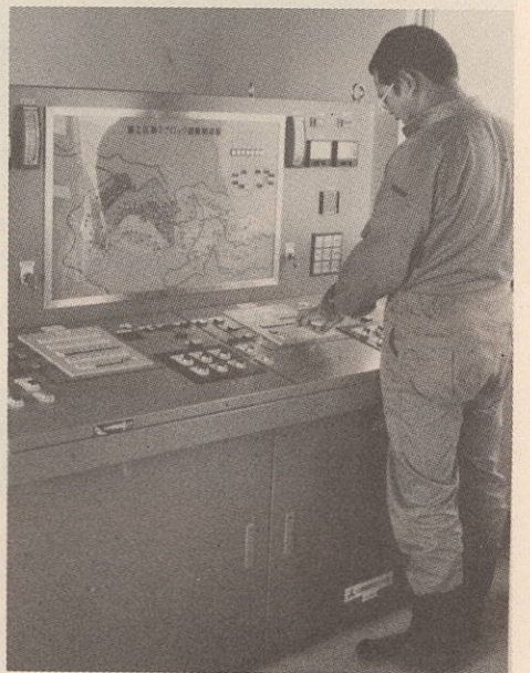
コンピューター内蔵の制御盤で集中管理
