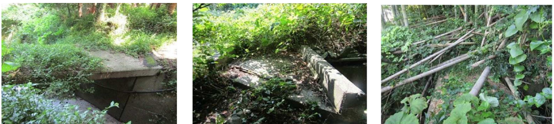
写真 1 集約化・撤去検討に取り組む橋梁例
