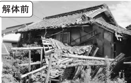
解体前は、住宅が崩れる危険性
