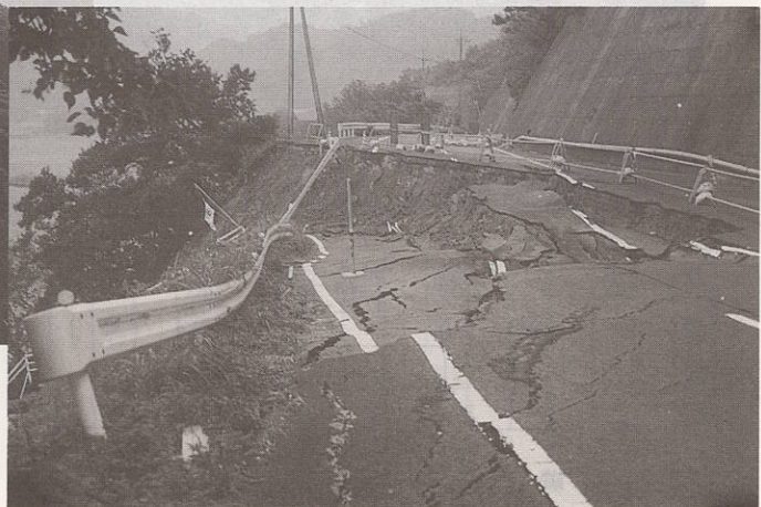
町道三崎～井野浦線 路肩が欠壊した (佐田地区)
