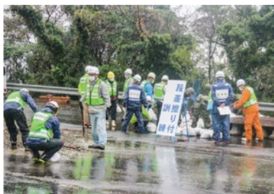
ガレキなど道路上の障害物の処理を行い、簡易な段差補修を行う道路啓開訓練を実施しました。
