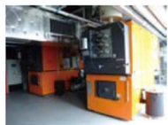
バイオマスボイラの利用
